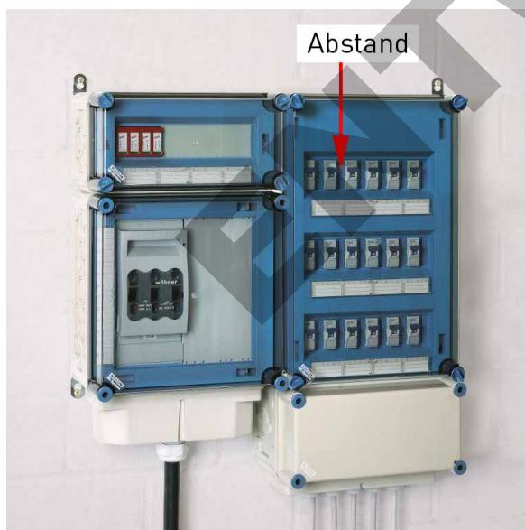
Bild 15: Verteiler für PV-Anlage Innenmontage:
