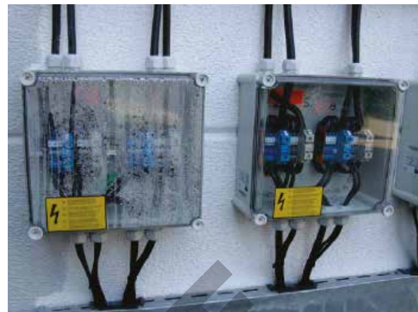
Bild 16: Kondenswasserbildung im Generatoranschlusskasten
