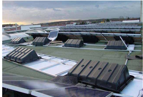
Bild 7: Sturmschaden durch Nichtbeachtung der Systemstatik
