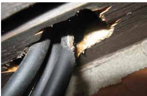
Bild 11 und 12: Beschädigungen von Leitungen
